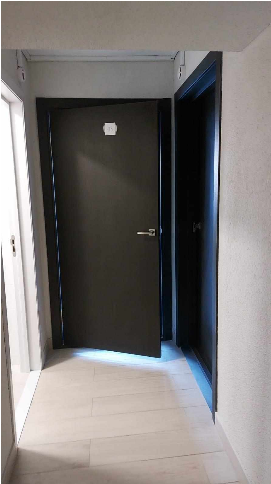
Томская область, г. Томск, проспект Ленина, д. 49 а (общежитие № 5), первый этаж, помещения №№27, 28, 29, 30, 31, 32, 33, 34 (часть). Дата съемки: 05.10.2023 г.
