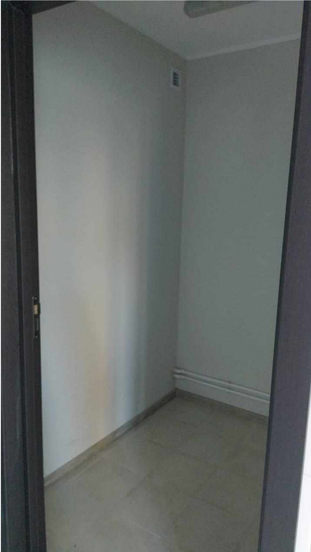
Томская область, г. Томск, проспект Ленина, д. 49 а (общежитие № 5), первый этаж, помещения №№27, 28, 29, 30, 31, 32, 33, 34 (часть). Дата съемки: 05.10.2023 г.
